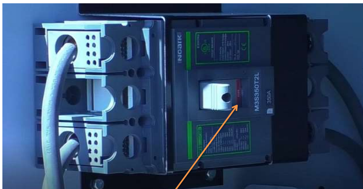
Interruttore automatico mostrato in posizione On. La barra rossa indica che l'interruttore è acceso. Si applica solo ai modelli del 2019.
